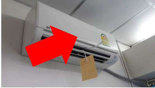
เครื่องปรับอากาศยี่ห้อ Mitsubishi แบบติดผนัง
