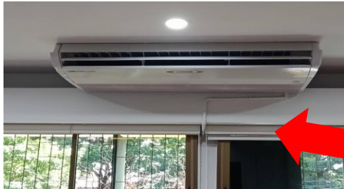
เครื่องปรับอากาศยี่ห้อ Central Air แบบแขวน
